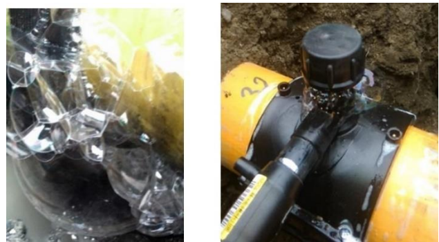
Obr. 5. Príklady netesných elektrofúzných spojov na plynovode [1]
